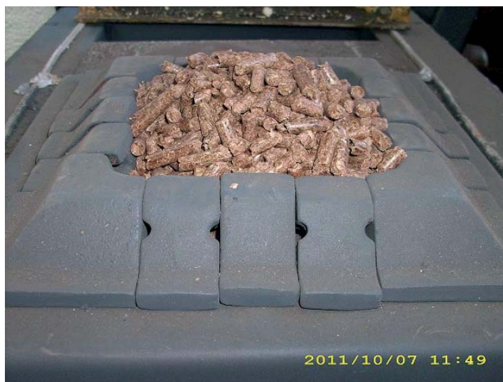
Рисунок 11. Горелка котла ТКАН
